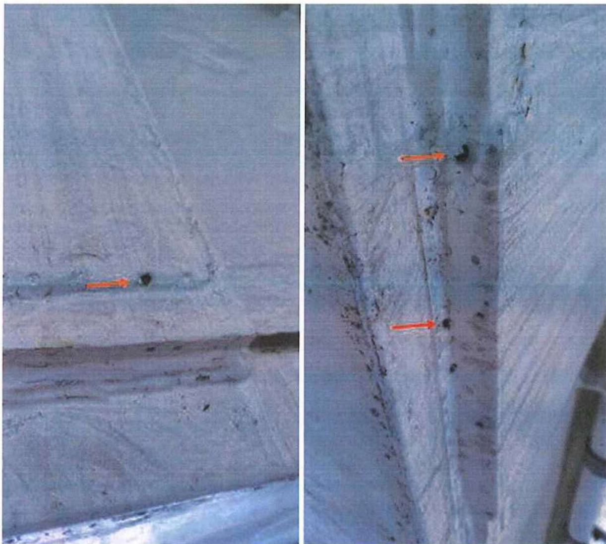
Figura 22 – Falta de fusão na junta soldada da tampa do tubo penetrante do segmento 24-25 do anel de compressão
