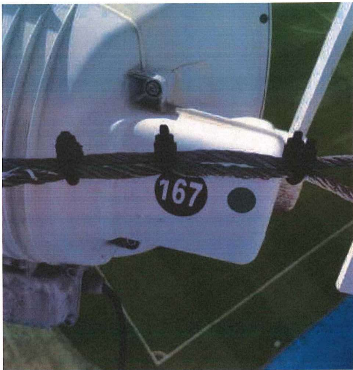
Figura 87 – Severa oxidação dos grampos da linha de vida em todos os eixos
