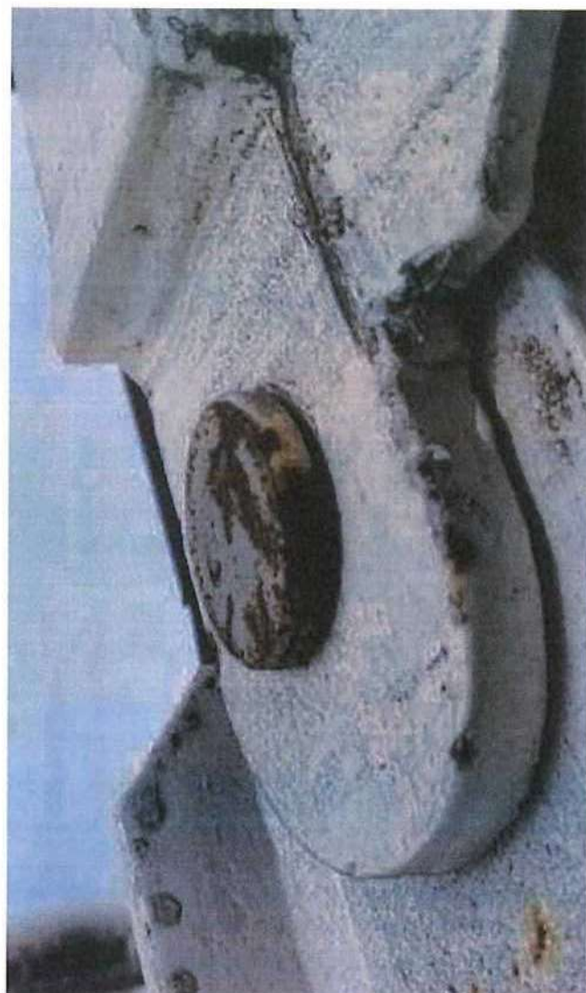
Figura 31 – Danos no revestimento do pino da ligação do mastro suspenso com a passarela tangencial e oxidação das áreas expostas no eixo 56.
