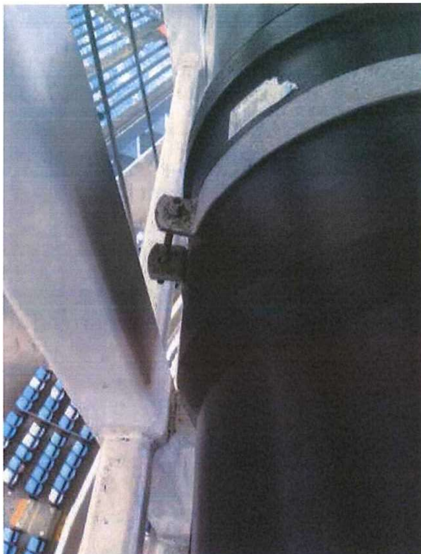
Figura 74 - Fixador oxidado e fora do padrão utilizado para fixação da braçadeira da tubulação de drenagem no segmento 35-36
