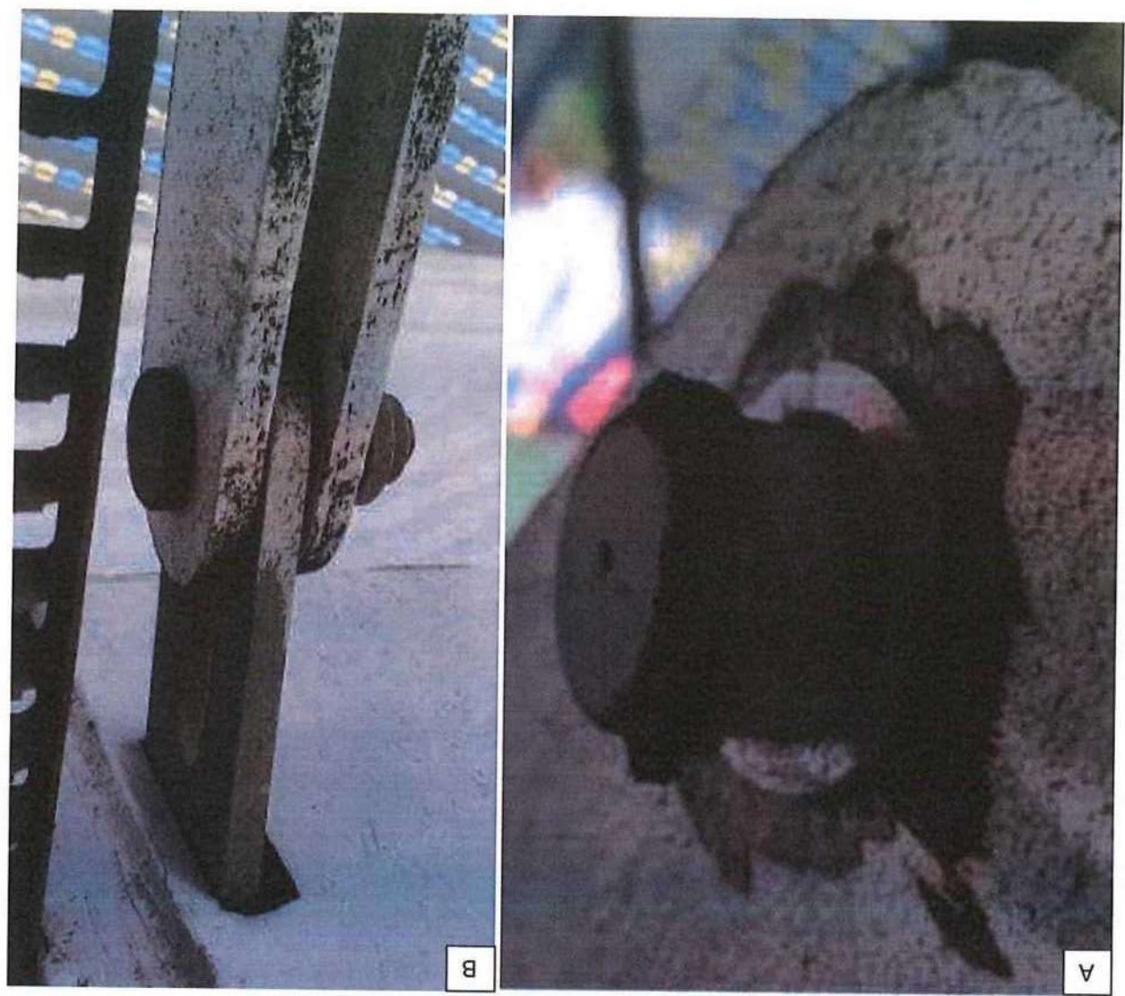
Figura 85 – (A) Oxidação no pino e anilha de travamento da ligação "passarela tangencial x passarela de acesso ao vídeo wall" bem como oxidação no olhal do eixo 24,5; (B) Oxidação do pino e tampa do pino da ligação "passarela de acesso ao vídeo wall e estrutura de suporte do telão" do eixo 6,5
