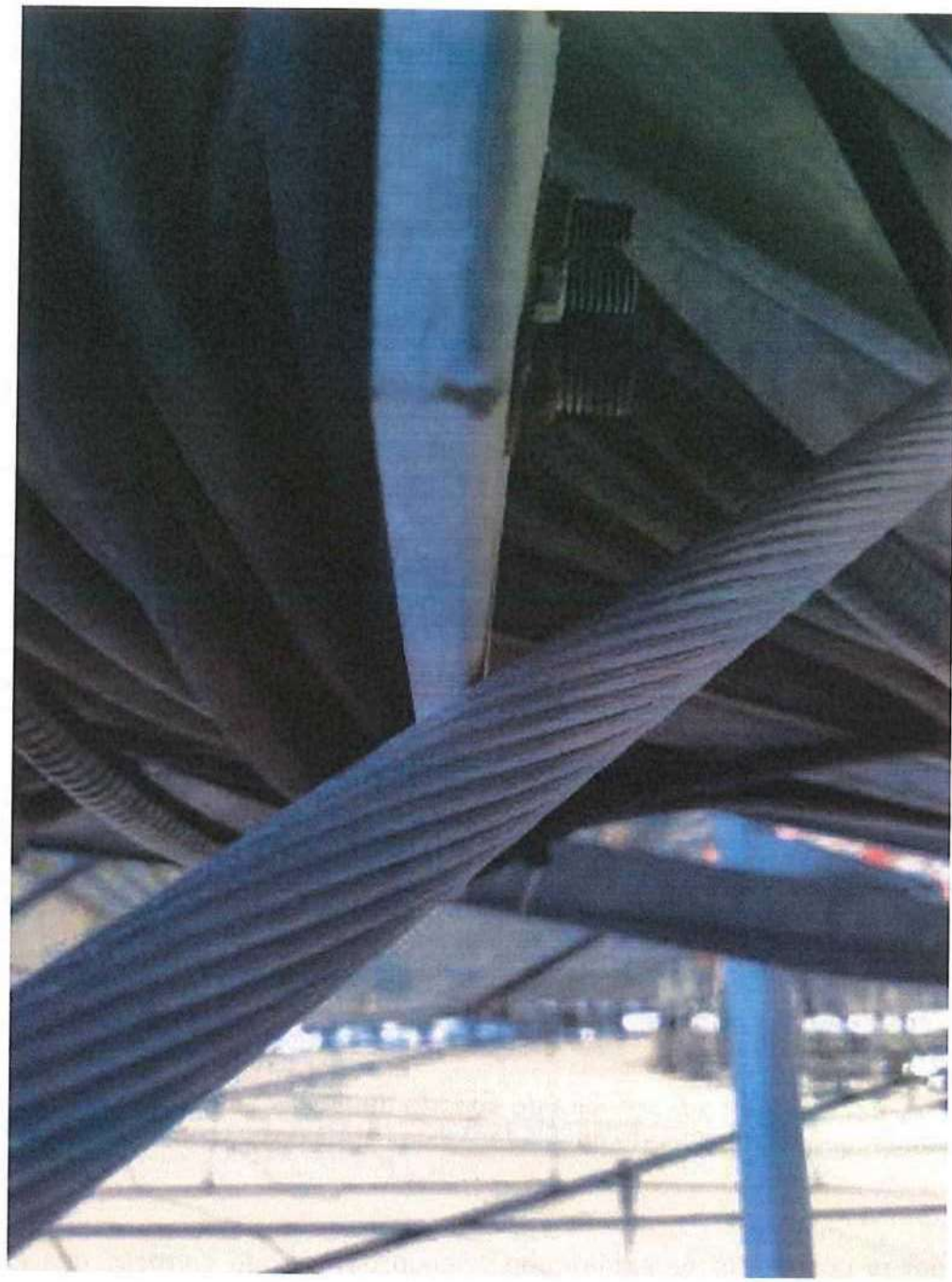
Figura 57 – Colisão entre o cabo do contraventamento lateral da passarela radial com eletrocalha do eixo 23,5
