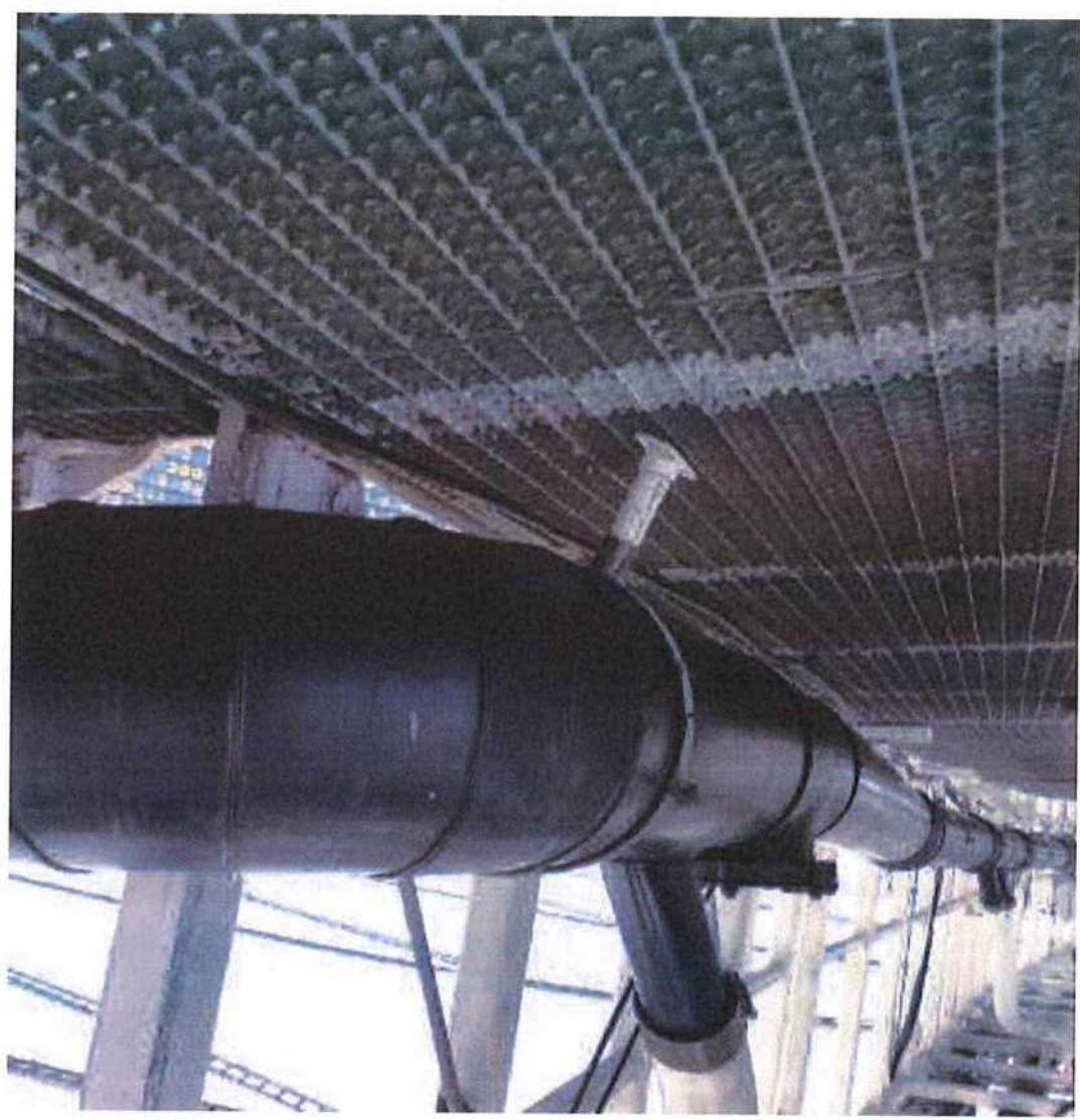
Figura 79 - Montagem indevida do suporte da tubulação de drenagem no segmento 53-54
