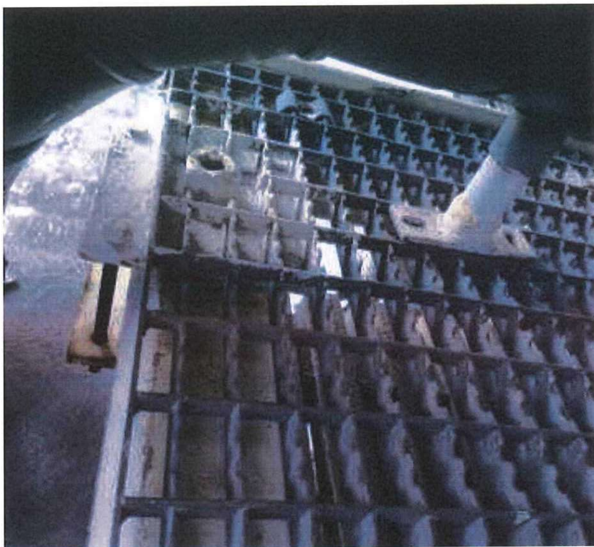
Figura 54 – Montagem indevida do suporte da tubulação de drenagem no eixo 7,5
