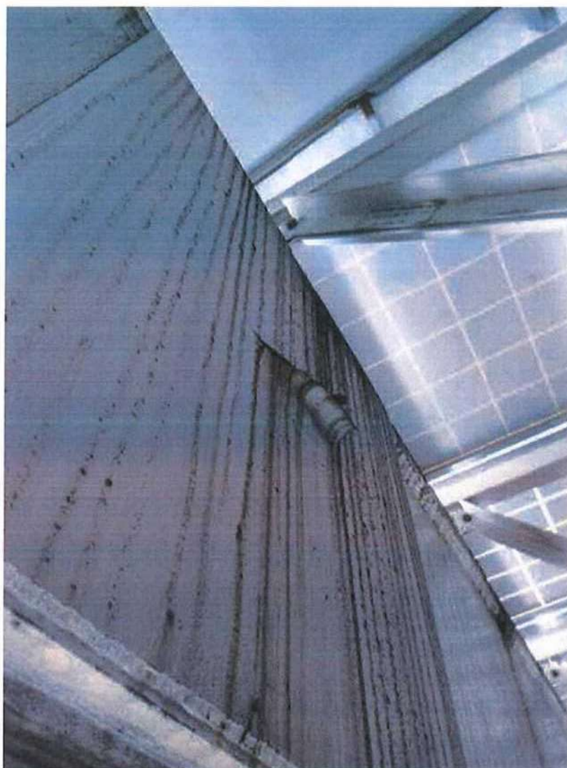
Figura 28 – Desplacamento do revestimento da chapa de fechamento do tubo penetrante do eixo 39-40
