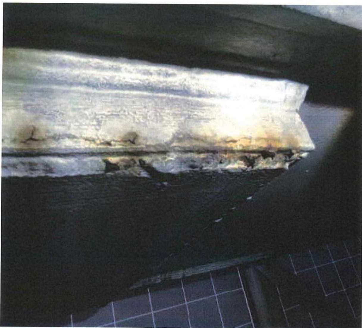
Figura 27 - Oxidação na junta soldada de fechamento do tubo penetrante e regiões adjacentes à solda no eixo 23.
