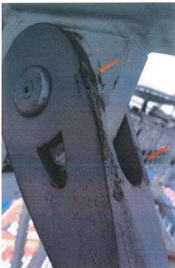
Figura 45 – Danos no revestimento anticorrosivo do soquete do cabo de contraventamento da passarela radial do eixo 23,5
