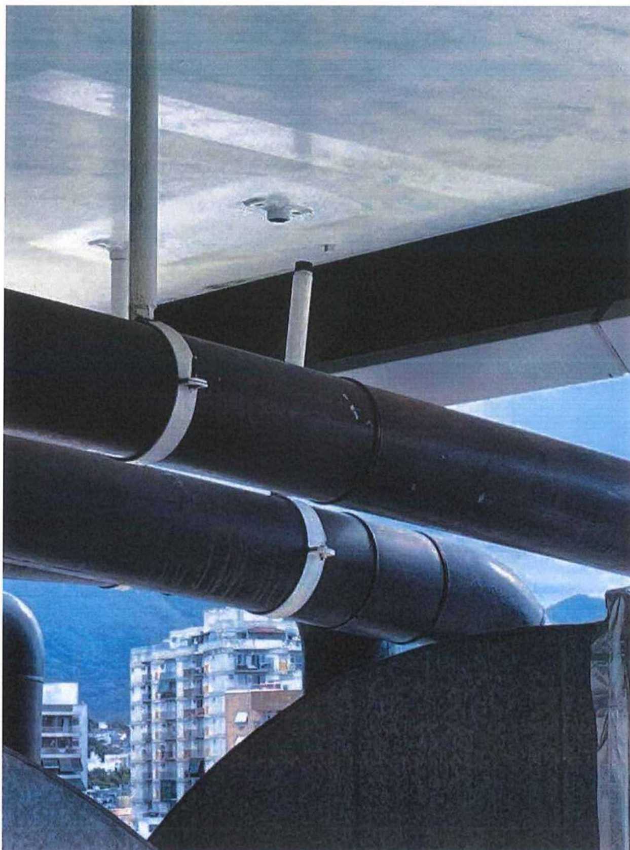
Figura 20 – Dutos de drenagem pendurados no anel metálico onde soltou-se uma ligação
