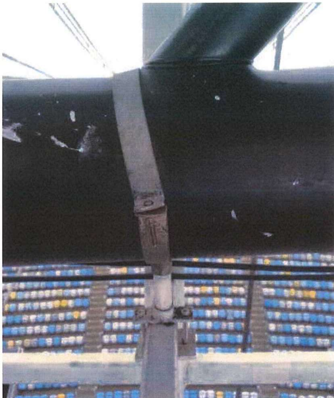
Figura 78 – Montagem indevida da braçadeira do suporte da tubulação de drenagem do segmento 50-51
