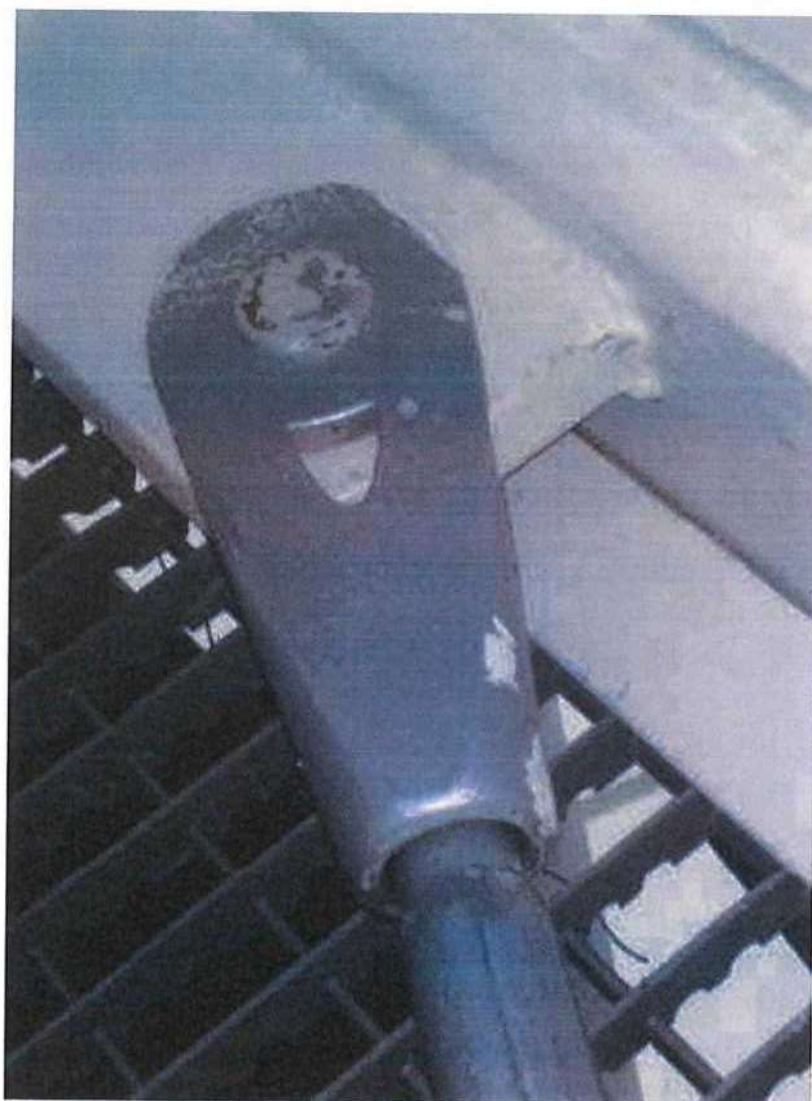
Figura 59 – Dano no revestimento e oxidação do pino do cabo de contraventamento da passarela radial do eixo 53,5
