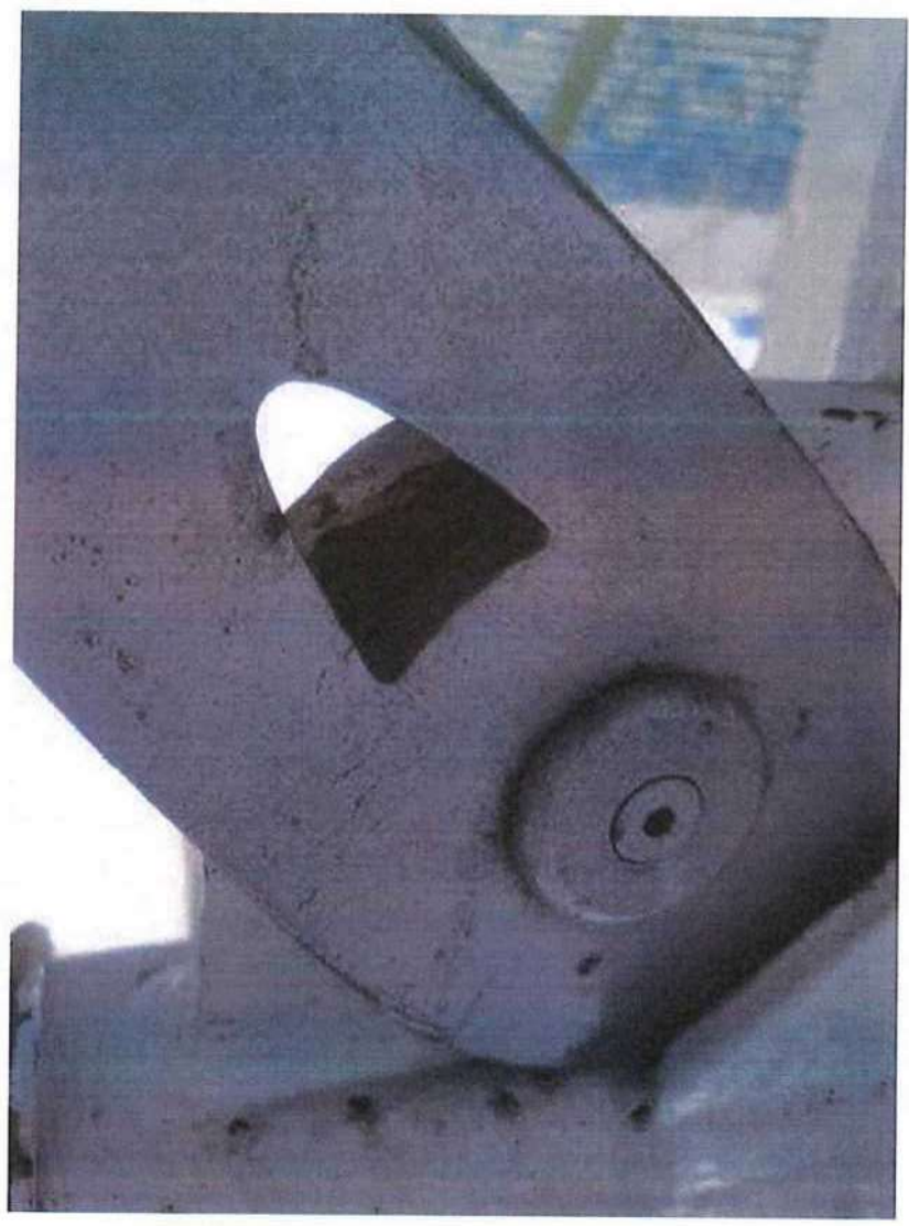
Figura 65 - Oxidação no olhal de fixação de um cabo de contraventamento do segmento 23-24 da passarela tangencial
