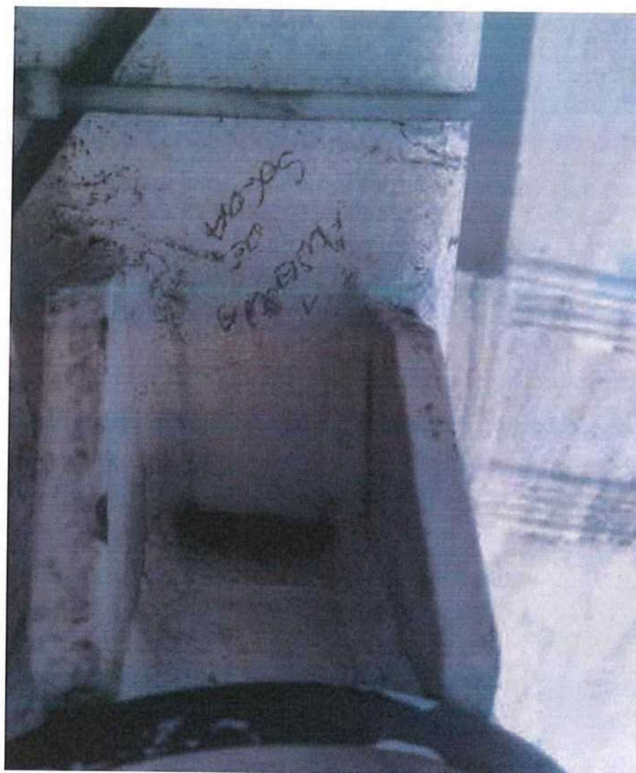
Figura 61 – Região não soldada próximo ao olhal da passarela tangencial do eixo 38
