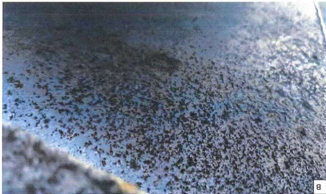
Figura 16 – (A) Respingos de concreto na superfície de aço inoxidável do aparelho de apoio do eixo 4; (B) Contaminação de aço carbono na superfície de aço inoxidável do eixo 35
