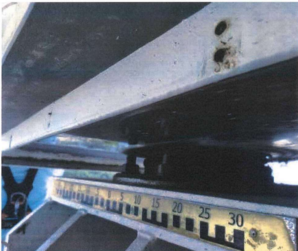
Figura 15 – Ausência da haste de indicação da régua graduada que mede o deslocamento radial do aparelho de apoio do eixo 55
