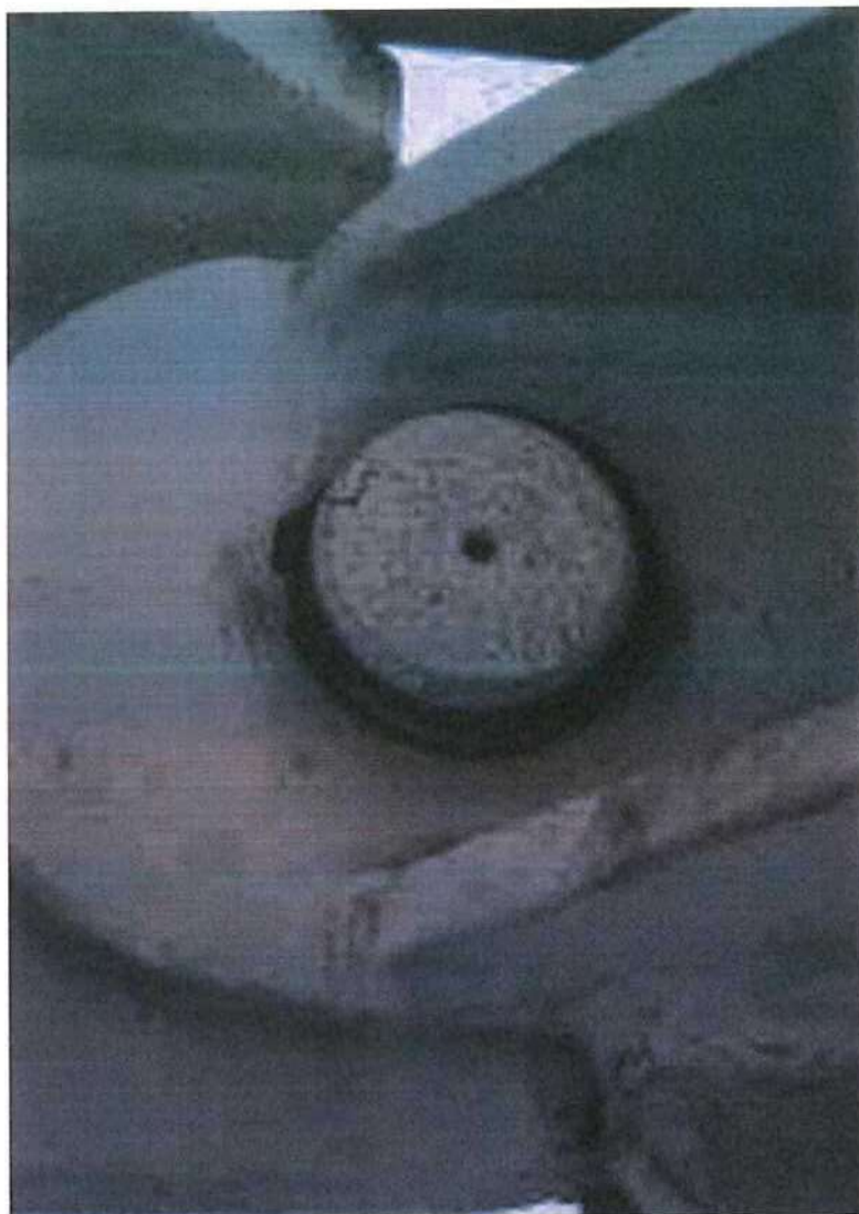
Figura 38 – Oxidação da anilha de travamento do pino do eixo 20 na ligação do mastro suspenso com a passarela tangencial
