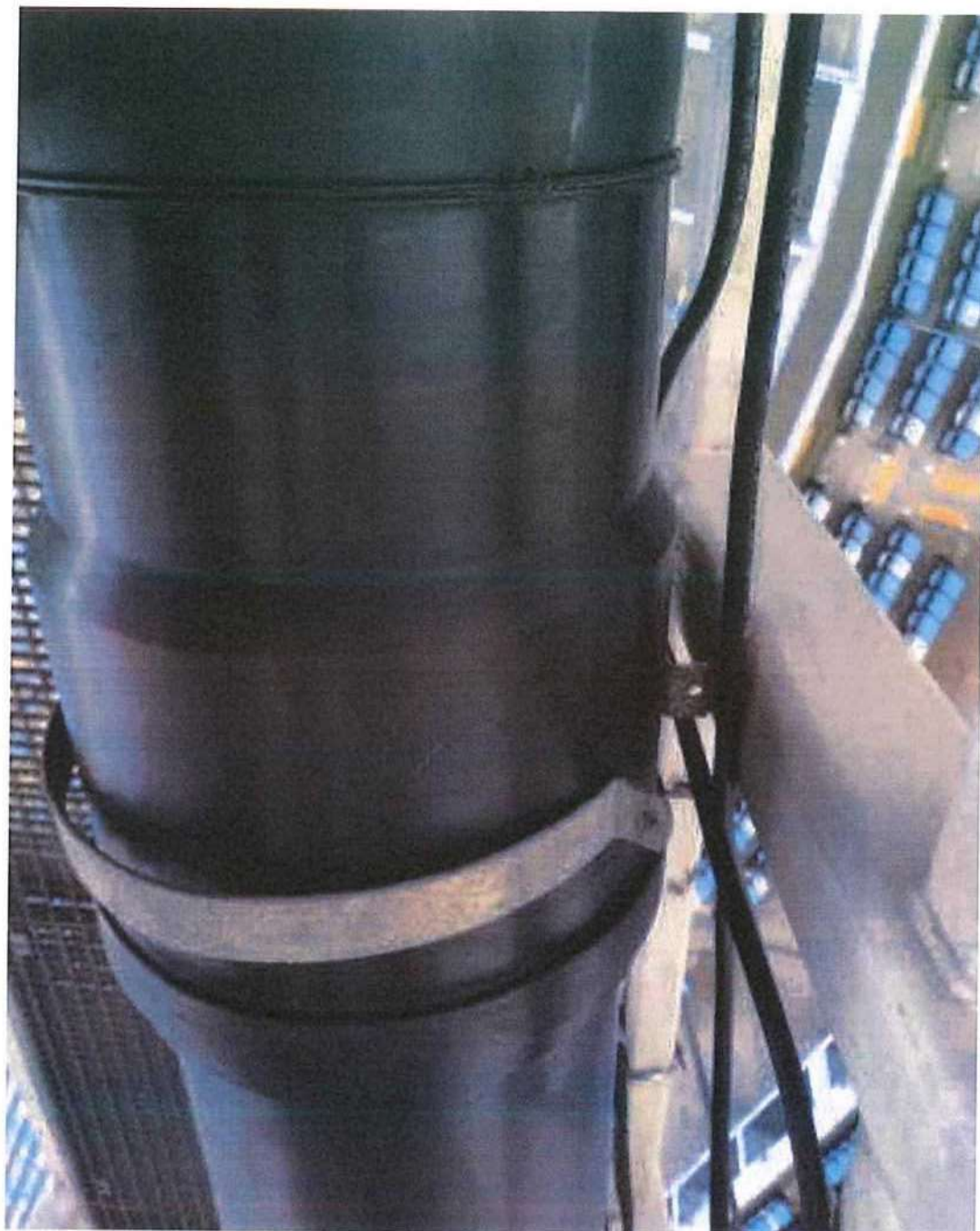
Figura 73 - Bragaadeira do sistema de drenagem sem fixador no segmento 5-6
