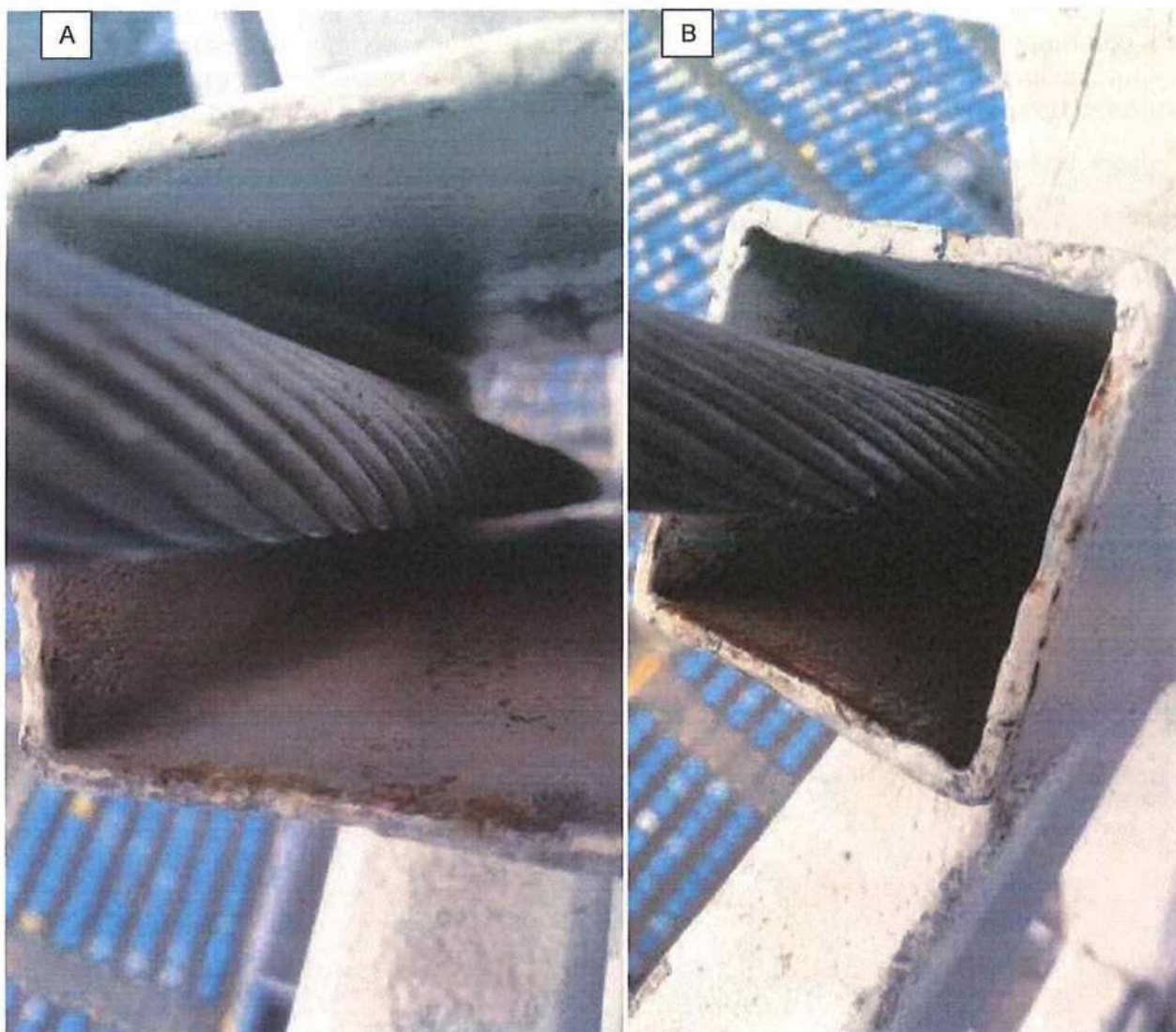
Figura 66 – (A) Oxidação na parte interna do tubo quadrado onde passam os cabos de contraventamento do segmento 53-54; (B) Oxidação na parte interna do tubo quadrado onde passam os cabos de contraventamento do segmento 23-24.
