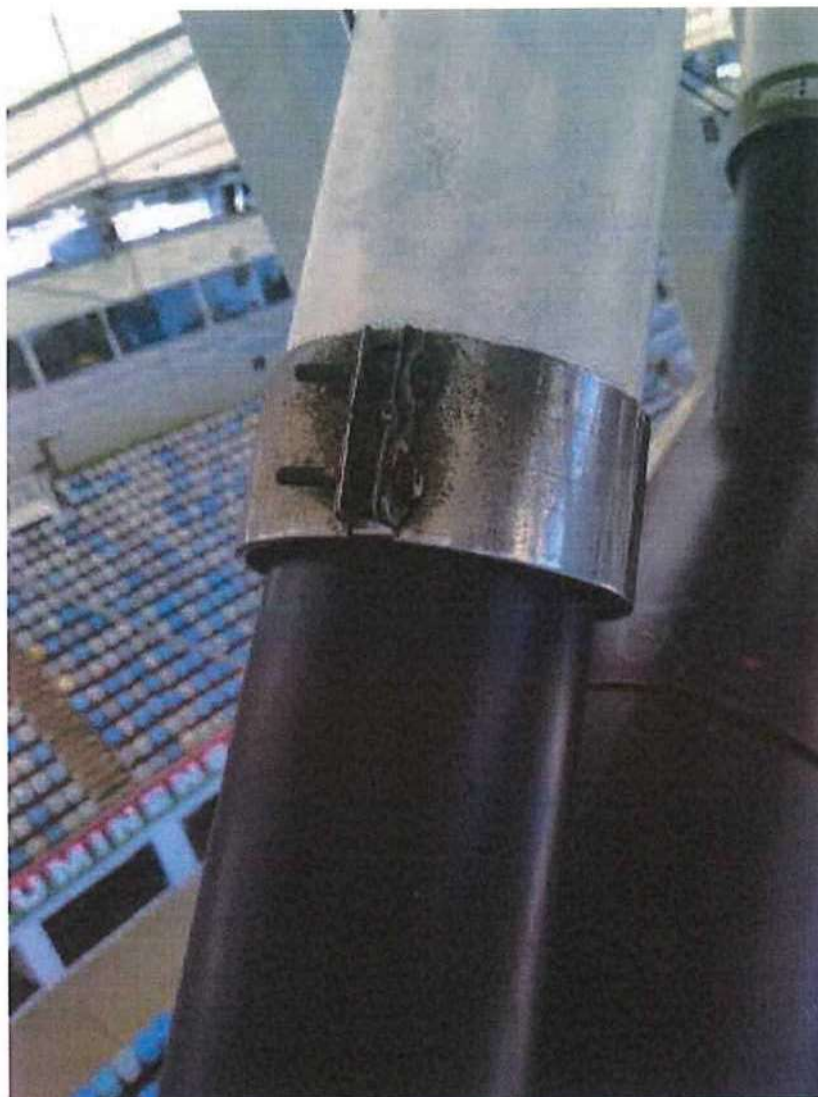
Figura 72 – Contaminação das braçadeiras do sistema de drenagem bem como fixadores oxidados do segmento 4-5.
